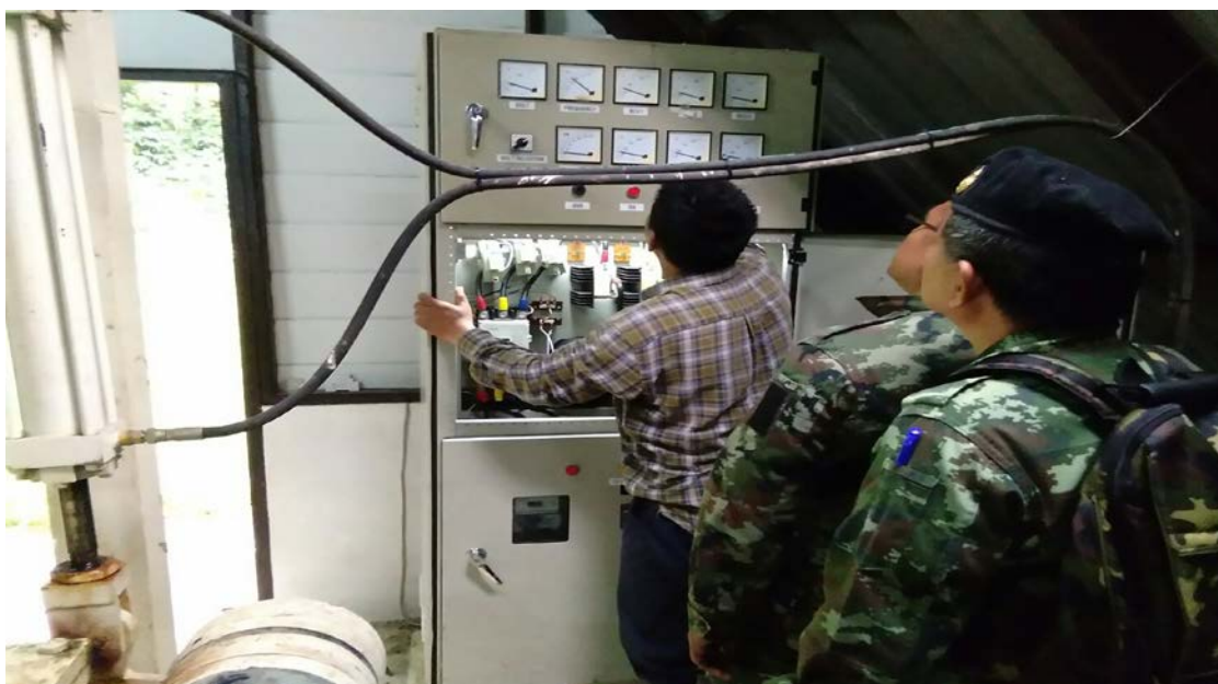
แผงควบคุมพลังงานน้ำ
